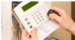
Installation et entretien de systèmes de sécurité
